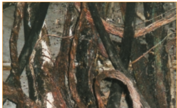
Ungeschützte PVC-Kabel nach dem Abbrand Unprotected PVC cables after the fire
