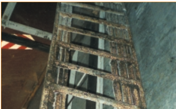
Geschützte PVC-Kabel nach dem Abbrand Protected PVC cables after the fire
