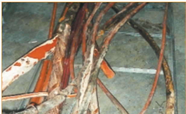
Halogenfreie Kabel mit nachgewiesenem Funktionserhalt nach dem Abbrand Non-halogenated cables with approved preserved operation time after the fire
