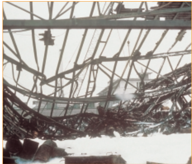
Ungeschützte Stahlkonstruktion nach Brandeinwirkung unprotected steel construction after a fire
