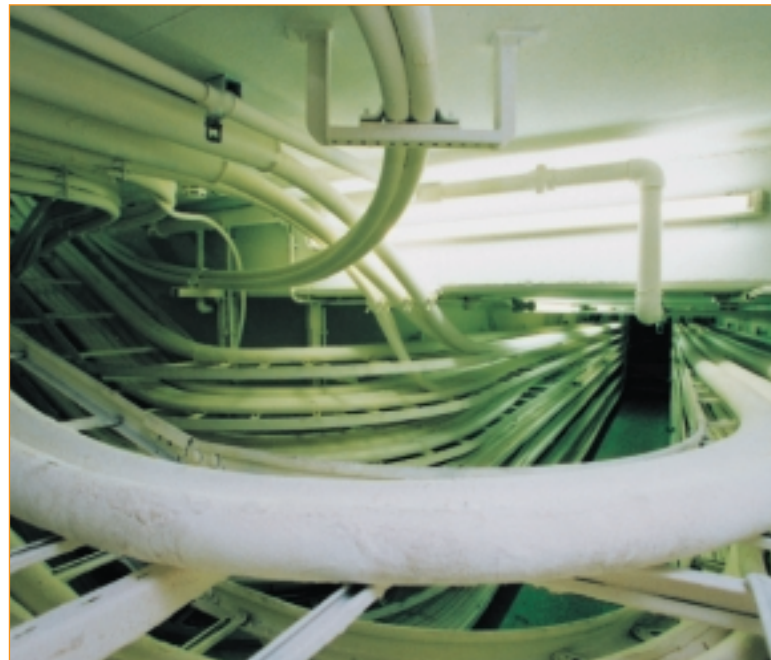
Kabelkeller in einem Kraftwerk Cable Trays in a Power Station
